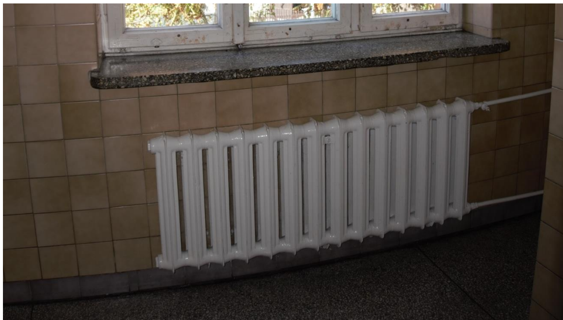
Zdjęcie 4. Widok instalacji c.o.
