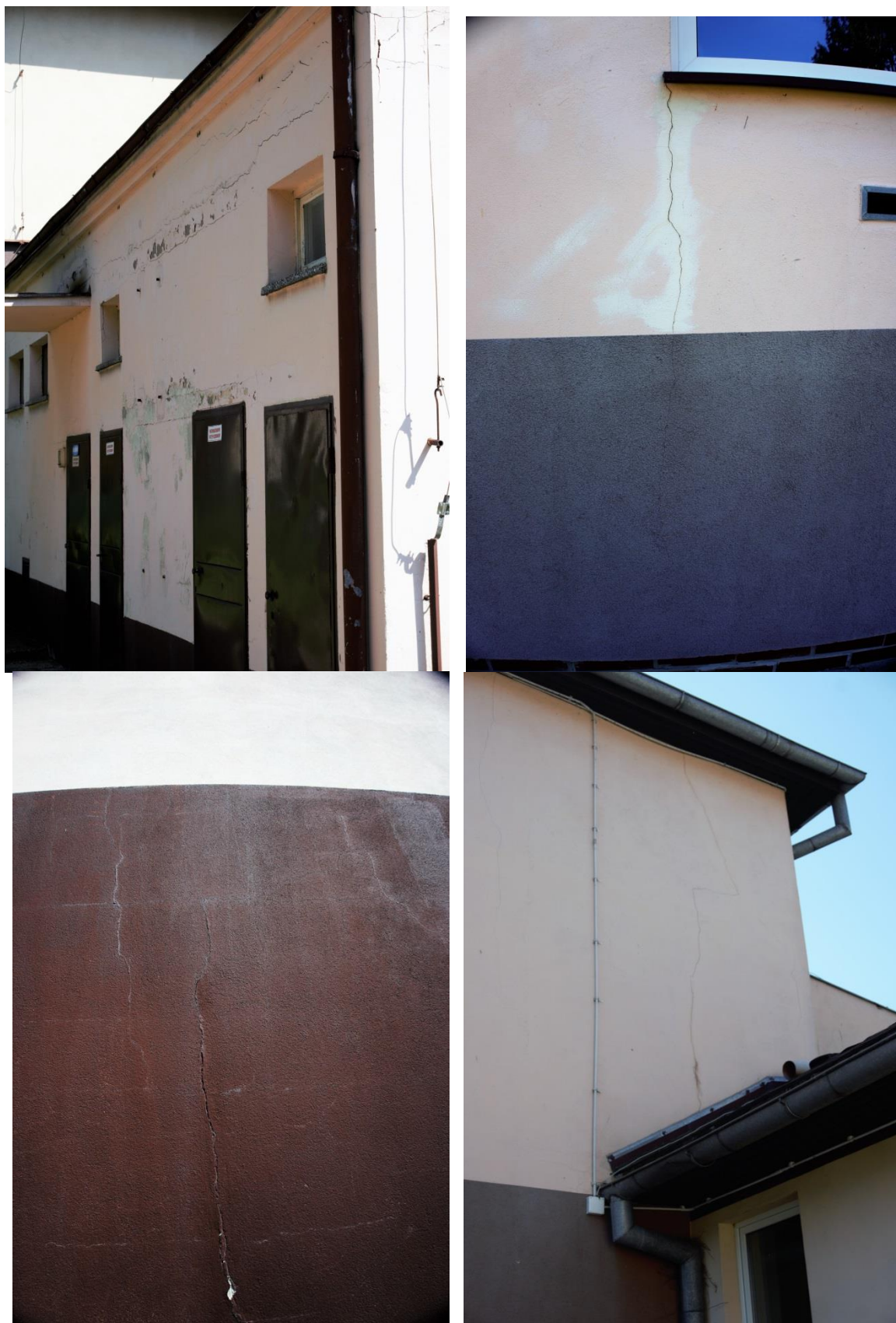
Zdjęcie 1. Widok zarysowań ścian zewnętrznych na części C.
