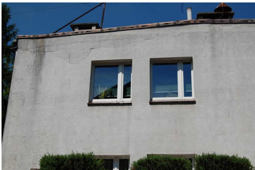
Rys. 1. Wypchnięty fragment ściany szczytowej bud. Szkoły od strony ul. W. Witosa.
